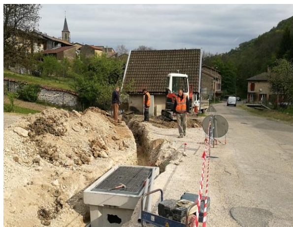
Installation du NRO au « Pèse-lait »
