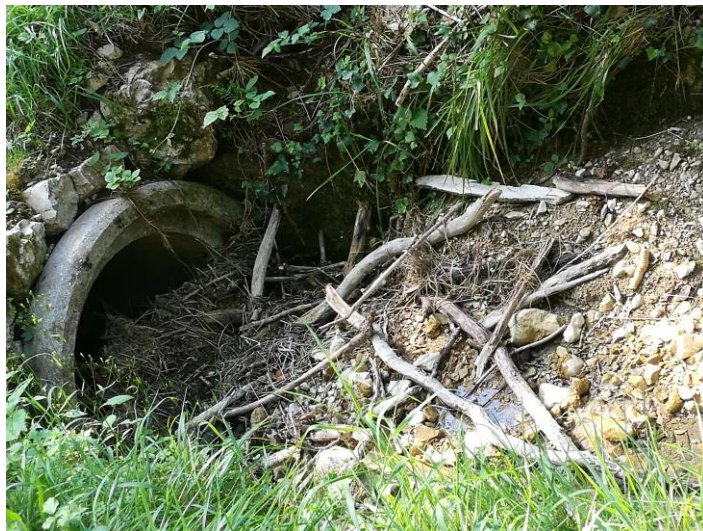
Des déchets végétaux ont bouché les évacuations
