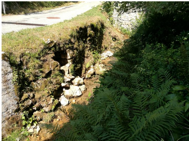
Le mur de soutènement de la route chez Gavet s'est fragilisé
