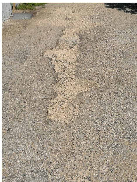
Des revêtements ont été endommagés : ici chez Gavet
