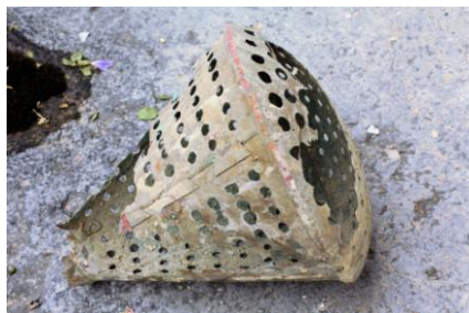
La crépine endommagée
